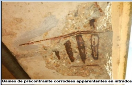
Gaines de précontrainte corrodées apparentes en intrados
